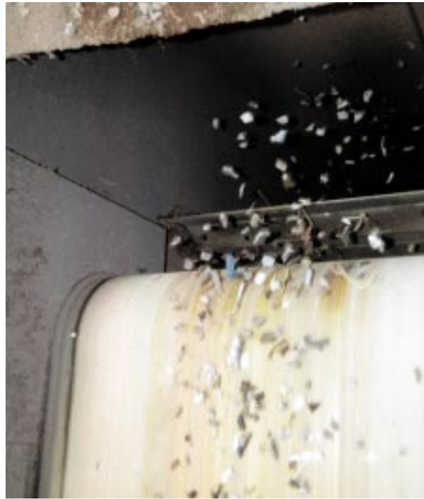
Metallseparierung mittels Wirbelstromscheidung.
